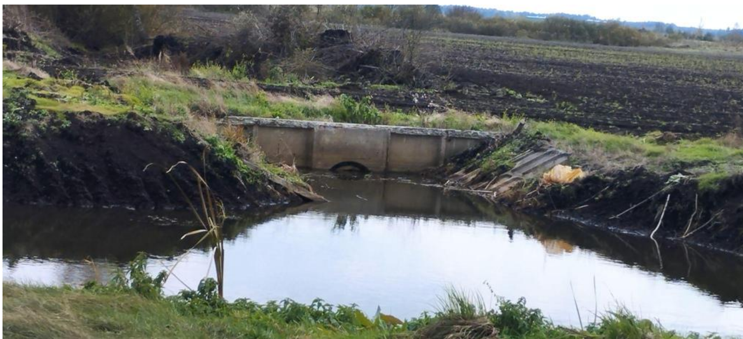
Трубчастий регулятор РТ-80 на каналі К-22 ПК0+20
